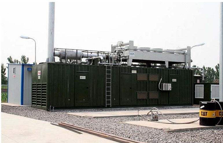
天津双口填埋气发电厂-发电机组 Generation module
